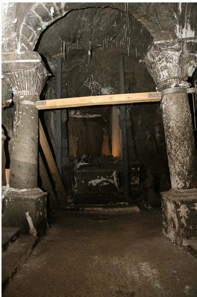
Rys. 11. Drewniana rozpora i stalowe kosze zabezpieczające kapitele kolumn w prezbiterium kaplicy po 2006 roku.
