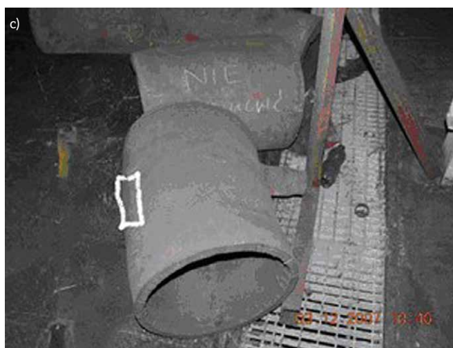
Rys. 1. Fragmenty instalacji energetycznych z zaznaczonymi miejscami pobrania próbek, od góry: a - komora wlotowa 15HM; b - komora wlotowa 20H12M1F; c - kolana 13HMF
