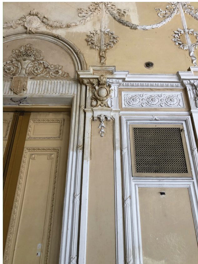
Fot. 5. Kratki z nawiewem świeżego powietrza umieszczone w ścianach; źródło: fot. własna
