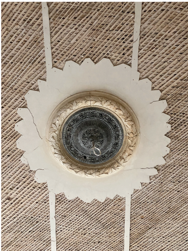
Fot. 4. Ozdobre wywiewy powietrza zainstalowane w rozetach sufitowych; źródło: fot. własna
