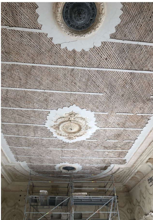
Fot. 6. Widok sufitu po skuciu tynku gipsowo-wapiennego z układem dranic służących jako podłoże nośne; źródło: fot. własna
