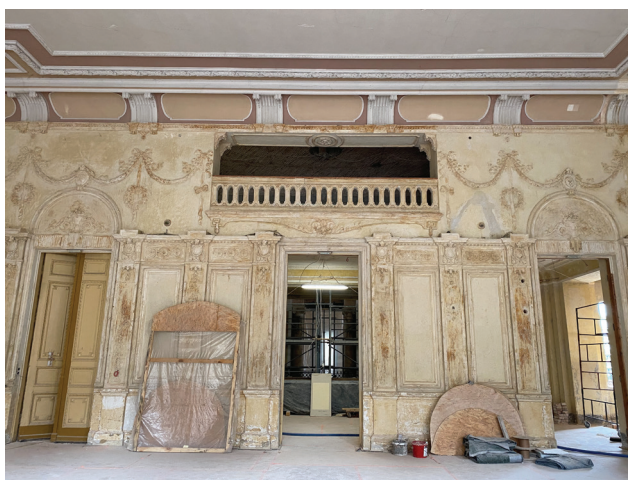
Fot. 3. Ściana północna – widok na balkon z barierą w typie plecionki; źródło: fot. własna
