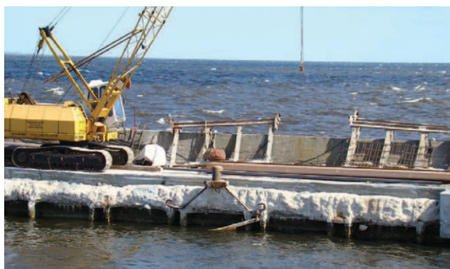
Fot. 3. Uszkodzenia belki cumowniczej falochronu wyspowego w Porcie Gdynia
