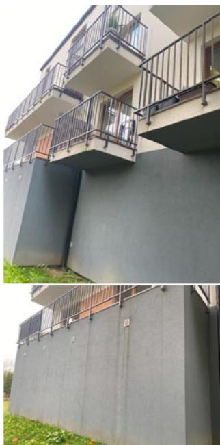
Rys. 3. Korozja biologiczna elewacji obiektu trzeciego
