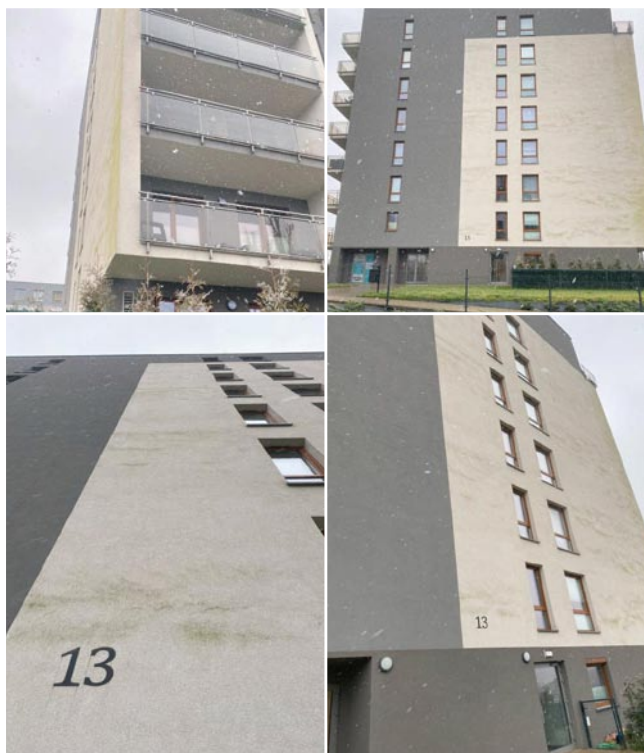
Rys. 2. Korozja biologiczna obiektu drugiego
