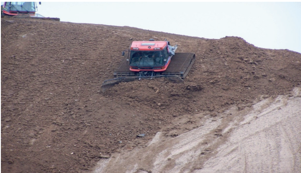
Fig. 3. Ratrack forming a fertile soil cover on the slope Rys. 3. Rozkładanie warstwy żyznej gleby na stoku za pomocą ratraka
