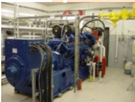
Rys. 17. Silnik do wytwarzania energii elektrycznej w Alvik. Źródło: Publikacja [16].
