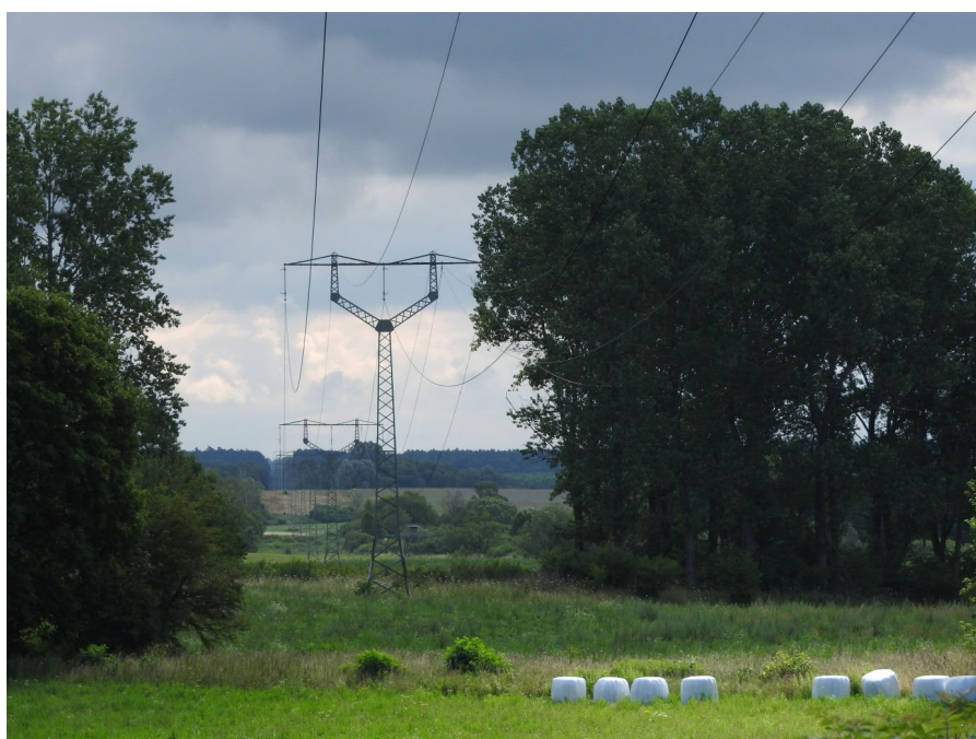
Fig. 4. High voltage line, 2016 (photo by M. Rzeszotarska-Pałka)
