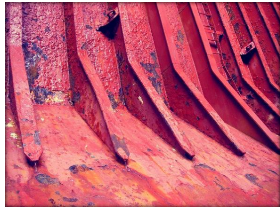
Rys. 6. Korozja spowodował uszkodzenia zmęczeniowe spoin wręgów i poszycia ładowni
