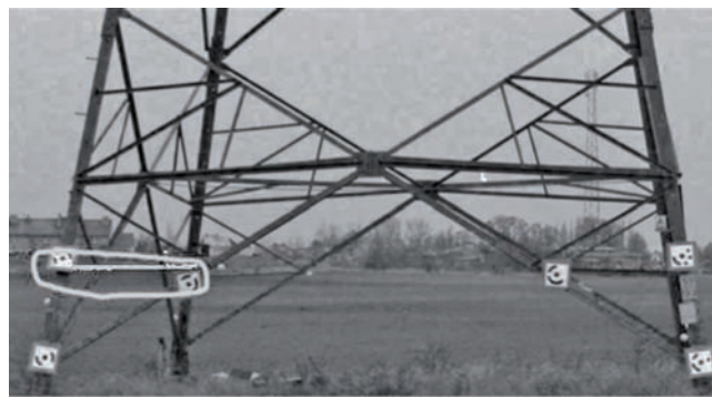
Rys. 6. Obraz z usuniętym fragmentem kratownicy Fig. 6. An image with a piece of truss removed
