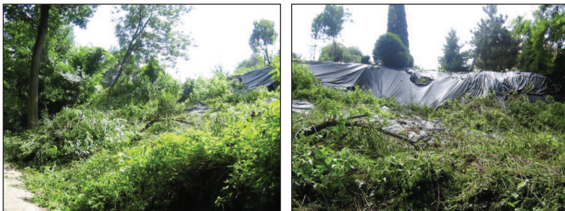
Rys. 2. Osuwisko w Wiencu, rok 2010 (fot. Turecki)
