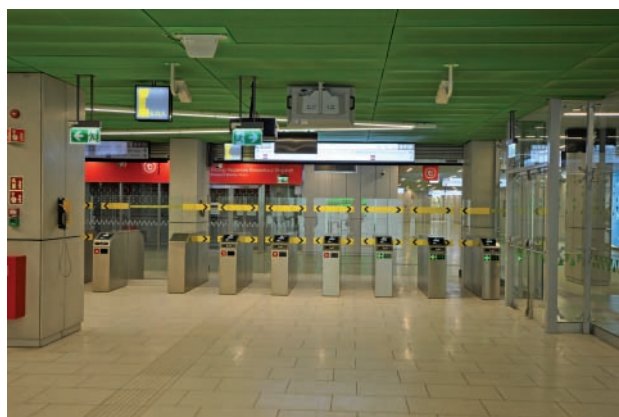
Rys. 14. Bramki biletowe na stacji Księcia Janusza (04.04.2020 r.) [fot. M. Graff]
