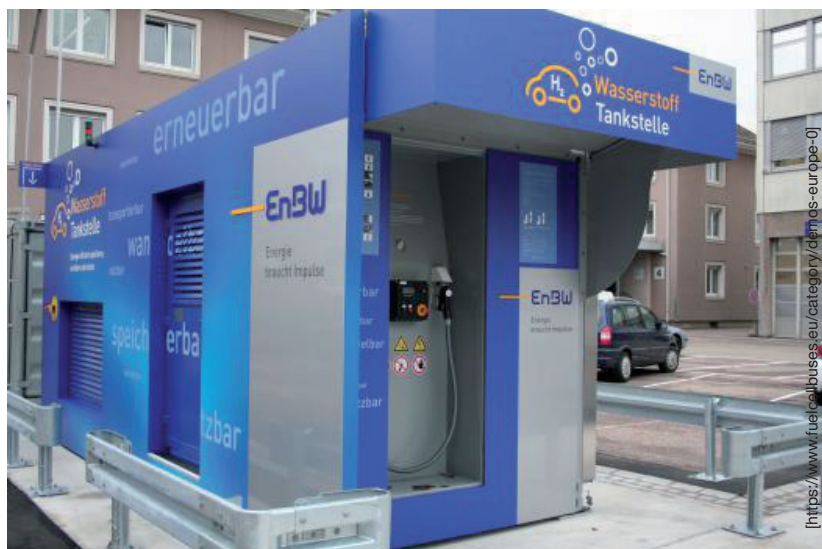
Rys. 1. Stacja tankowania wodoru w Karlsruhe z dostarczaniem wodoru z zewnątrz za pomocą rurowozu, z możliwością magazynowania 100 kg wodoru oraz ciśnieniem tankowania 350 i 700 bar
