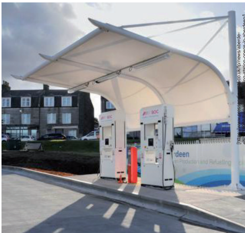
Rys. 4. Stacja tankowania wodoru z produkcją wodoru poprzez elektrolizę wody w Aberdeen z możliwością magazynowania 420 kg wodoru, i ciśnieniem tankowania 350 bar
