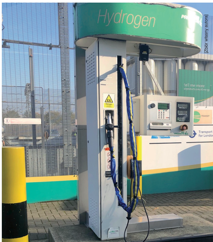
Rys. 2. Stacja ładowania wodoru w Londynie w zajezdni autobusowej przystosowana do magazynowania wodoru w ilości 180 kg i ciśnieniu tankowania 350 bar
