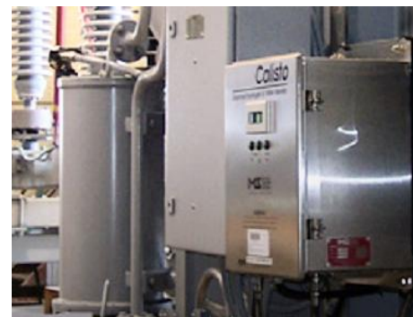
Rys. 5. Charakterystyka czujnika chromatografu CALISTO (z lewej) oraz widok chromatografu CALISTO zainstalowanego na transformatorze (z prawej) [5]
