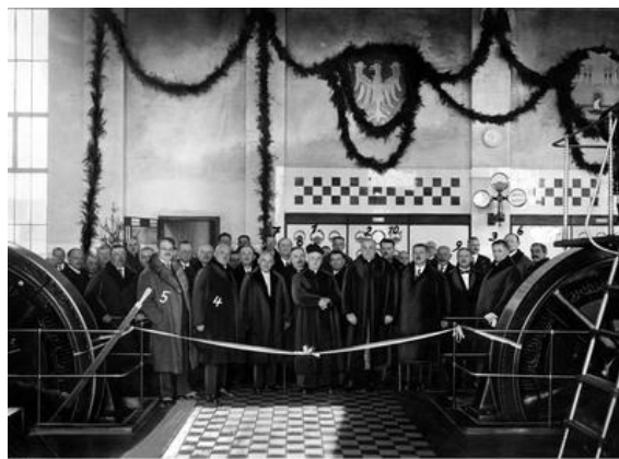
Rys. 7. Poświęcenie elektrowni w Jarosławiu w 1930 roku, Sokolnickiego podpisano numerem 3 (źródło: Narodowe Archiwum Cyfrowe)
