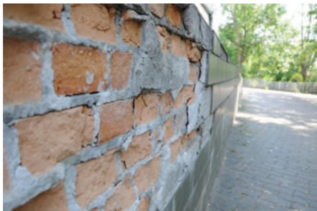
Rys. 1. Uszkodzenia mrozowe muru z cegły z odspojeniem okładzin
