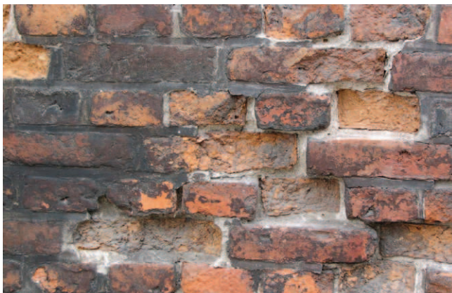
Rys. 5. Widok muru ceglanego uszkodzonego wskutek korozji mrozowej [1]
