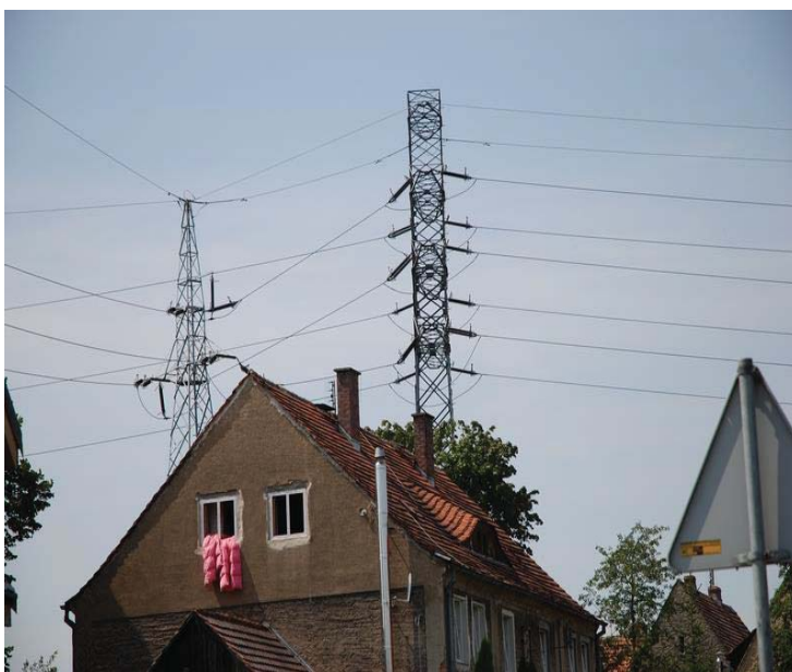
Rys. 2. Przykład nietypowego układu linii 110 kV zlokalizowanego w bezpośrednim sąsiedztwie budynków mieszkalnych
