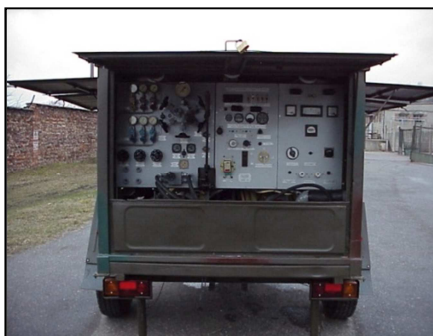
Rys. 6. Zestaw zasilania bazy zabezpieczenia prac podwodnych "ORTOLAN" - panel kontrolny.
