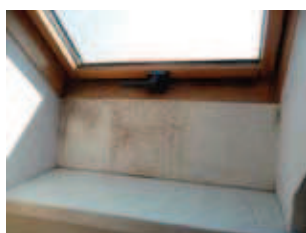
Rys. 8. Poziomy parapet pod oknem połaciowym, utrudnia opływ powietrza
