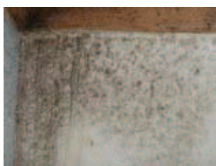
Rys. 9. Pionowa ścianka podokienna pokryta grzybami pleśniowymi
