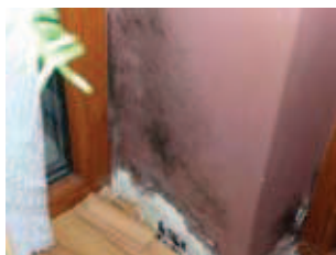
Rys. 2. Kolonie pleśni na ścianie przy podłodze
