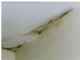
Rys. 3. Kolonie pleśni w narożu ścian ze stropodachem
