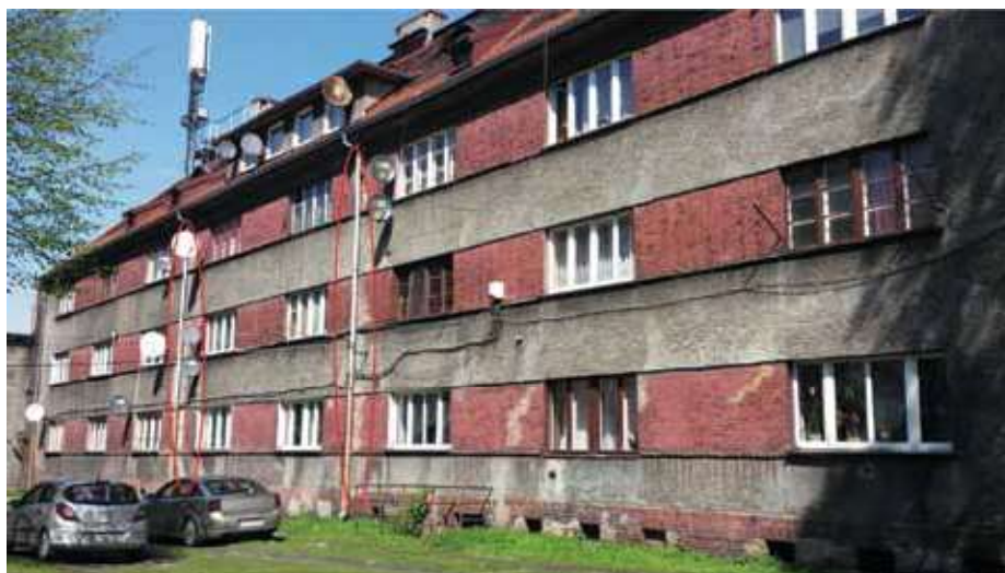
Rys. 6. Strefy osłabione w przeszłości, obecnie przemurowane, bez zarysowań na zewnętrznej, podłużnej ścianie północnej
