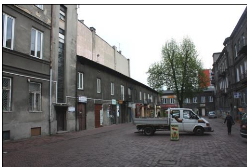
Rys. 2. Aleje NMP 31. Wnętrze podwórza. Widoczne na zdjęciu ściany kamienic wymagają prac remontowych. Cała przestrzeń wymaga uporządkowania
