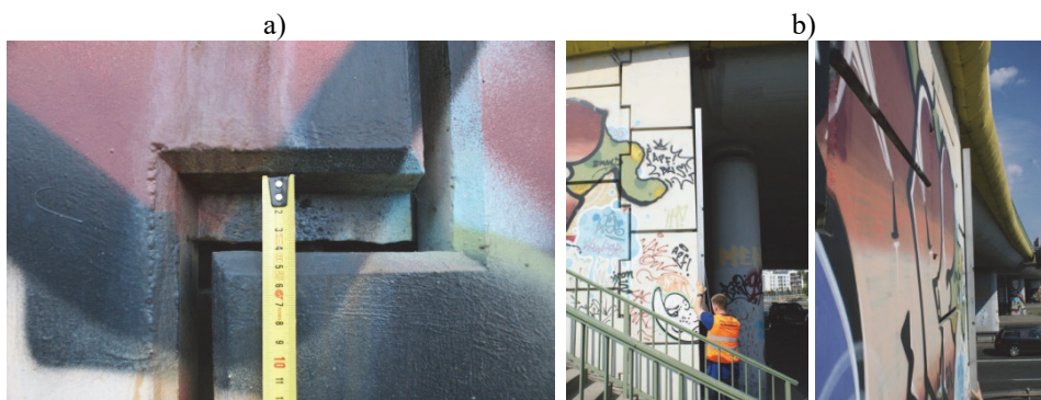
Rys. 13. Przykłady deformacji układu prefabrykowanych paneli przyczółka z gruntu zbrojonego podpory P1: a) zwiększone odstępy między panelami, b) przemieszczenia poziome paneli
