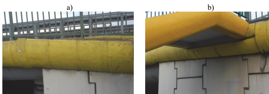
Rys.14. Przykłady istniejących kap chodnikowych: a) ściana boczna – wiadukt 452, b) ściana boczna z pomostem schodów – wiadukt 452
