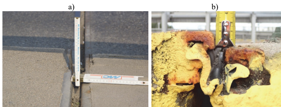
Rys. 5. Uskoki na urządzeniach dylatacyjnych: a) widok od góry, b) widok z boku
