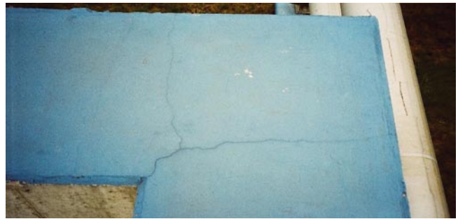
Rys. 7. Zarysowania w narożu na górnej krawędzi zbiornika (zdjęcia wykonane przez Buczkowskiego podczas jednej z ekspertyz)
