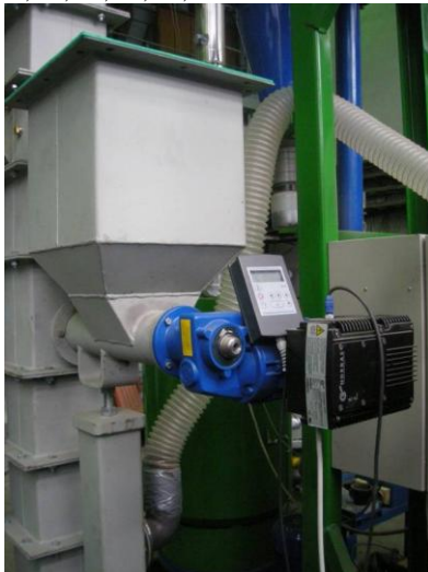
Rys. 1. Widok podajnika ślimakowego zamontowanego na zasobniku regeneratu. Widoczny panel z przemiennikiem częstotliwości do ustawiania prędkości obrotowej ślimaka
