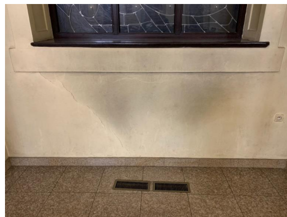
Rys. 3. Kratki nadmuchowe oraz widoczne ubrudzenie ściany przy kratkach
