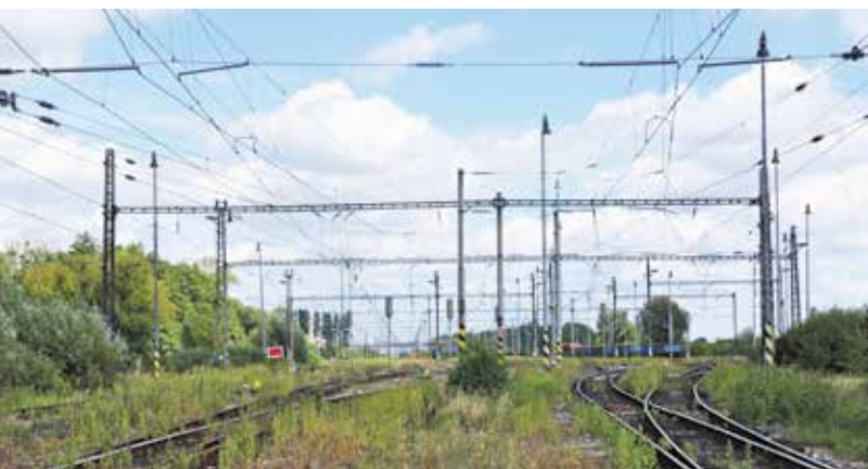
Stacja Maťovce, zachodnia głowica wyjazdowa (3 kV DC), Słowacja (14.08.2016 r.)
