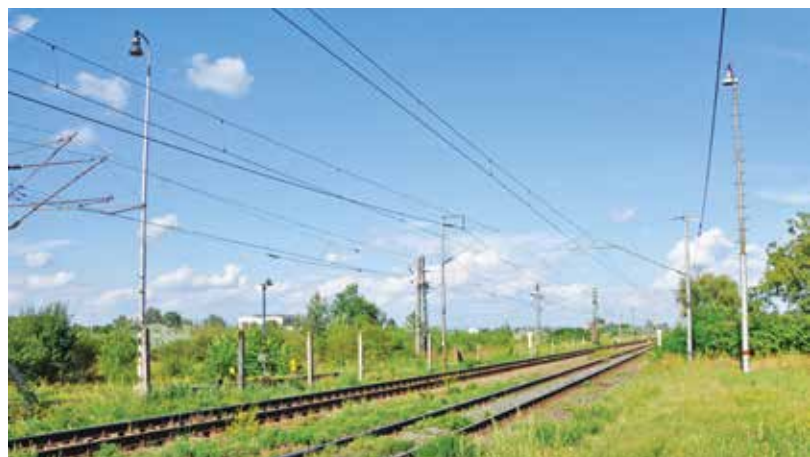
Stacja Čierna nad Tisou, zachodnia głowica wyjazdowa (3 kV DC), Słowacja (14.08.2016 r.)
