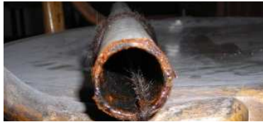
Rys. 5. Widok skorodowanej próbki ze stali węglowej RST34 w płaszczu z polipropylenu.
