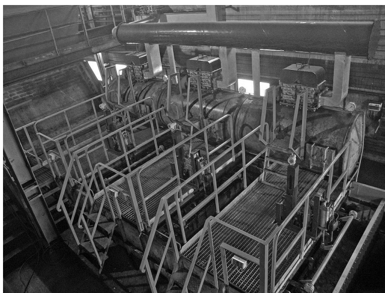
Rys.1 Widok osadzarki OM20 w KWK Rydułtowy-Anna [12]
