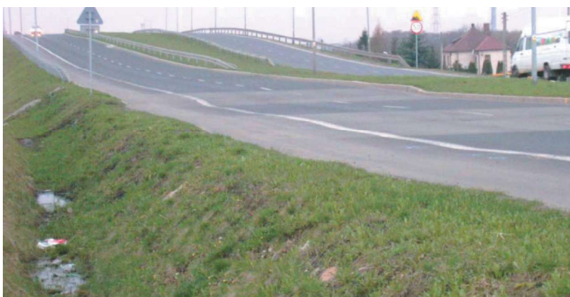
Rys. 7. Deformacje jezdni południowej Fig. 7. Deformations of the southern roadway
