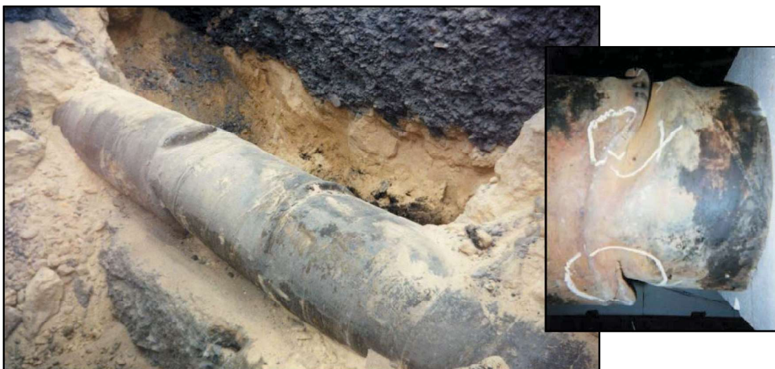
Rys. 12. Przykład wybożenia i deformacji ścianek gazociągu stalowego (Wójcikowski, Machowicz 2008, Jachim, Kalisz 2010)
