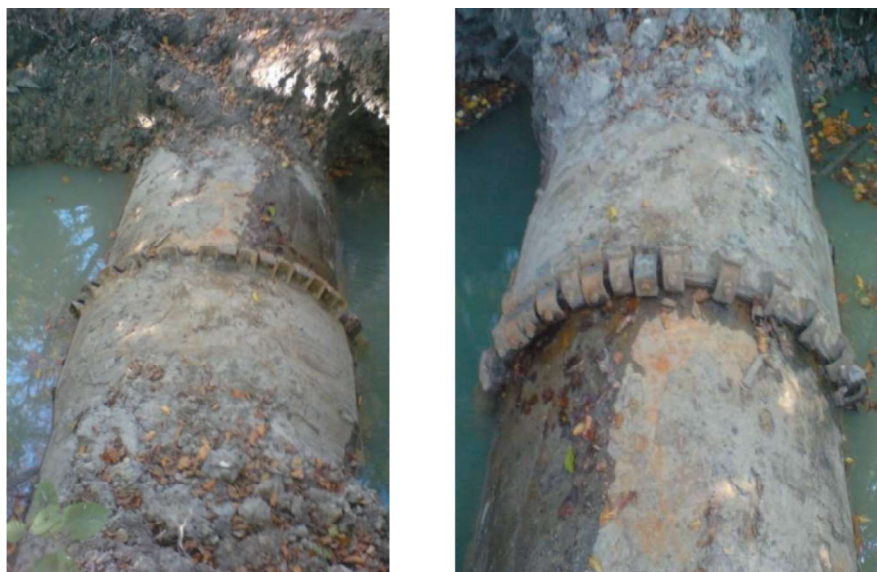
Rys. 14. Przykład rozszczelnienia kompensatora wodociągu stalowego na terenie górniczym Fig. 14. The example of unsealing a compensator of a steel water pipeline in the mining area
