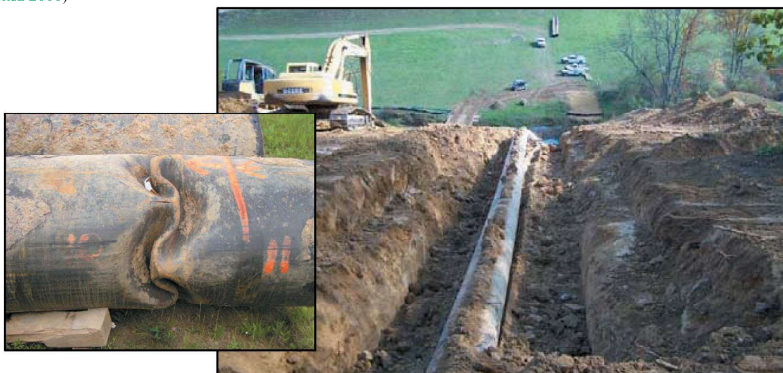
Rys. 13. Przykład wybożenia i deformacji rurociągu stalowego o konstrukcji ciągłej wskutek oddziaływania ścianowej eksploatacji węgla kamiennego w USA (Francini 2011)
