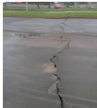
Rys. 8. Deformacje nawierzchni jezdni północnej Fig. 8. Deformations of the northern roadway
