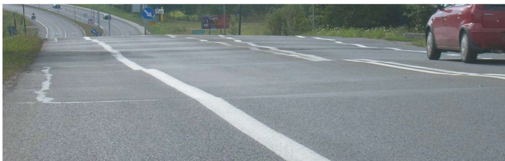
Rys. 2. Deformacje nieciągłe jezdni, widok od strony zachodniej
