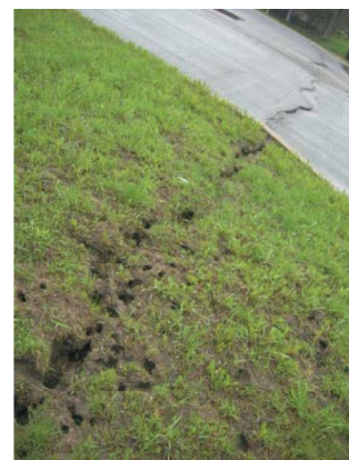
Rys. 10. Uszkodzenia jezdni i pasa dzielącego Fig. 10. Damage to the roadway and the median strip
