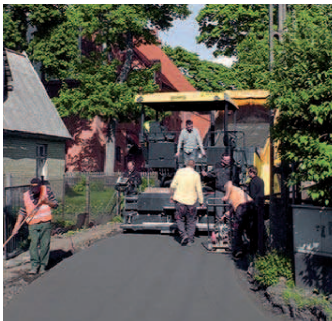
Rys. 6. Rozścielacz BOMAG BF800C w trakcie układania nawierzchni z betonu wałowanego (źródło: Firma Harat S.J.)
