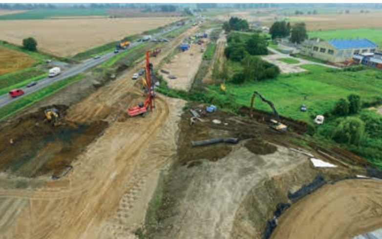
Droga S7 w km 42 + 200 (widok w kierunku Elbląga), na wysokości miejscowości Kmiecin – wbijanie drenów prefabrykowanych
