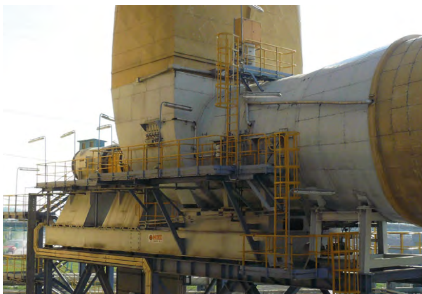
Fot. 9. Wentylator wspomagający (Booster Fan) absorbera D
