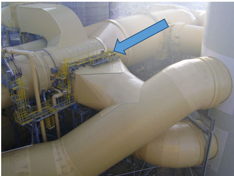
Fot. 11. Widok na klapę obejściową Absorbera C
