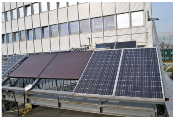
Rys. 3. System fotowoltaiczny Zakładu Termodynamiki i Mechaniki Płynów
