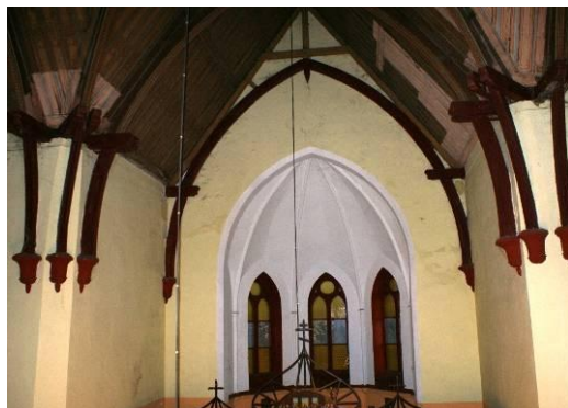
Ryc. 1. Konieczne jest odtworzenie zniszczonych konsol podtrzymujących drewniane łęki konstrukcji dachu. Źródło: fot. H. Rutyna XI.2010
