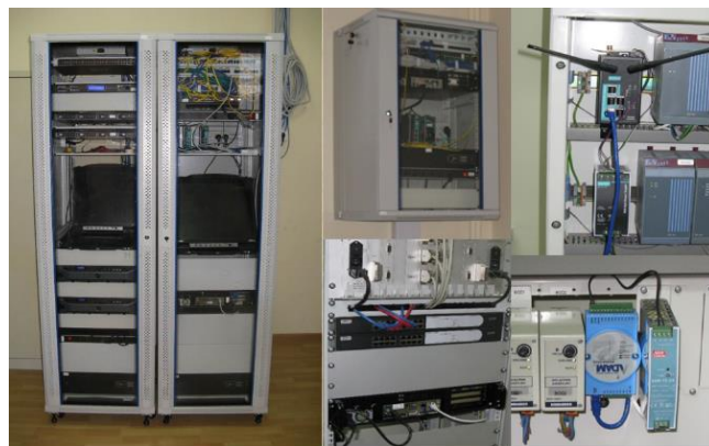
Rys. 6. Serwer baz danych i urządzenia komunikacyjne zainstalowane w laboratoriach Wydziału Transportu i Elektrotechniki Uniwersytetu Technologiczno-Humanistycznego w Radomiu w ramach projektu badawczego PBS/A6/29/2015 [opracowanie własne]
