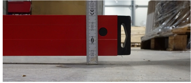
Rys. 6. Niespełnione wymaganie płaskości posadzki Fig. 6. Unfulfilled requirement for floor flatness
