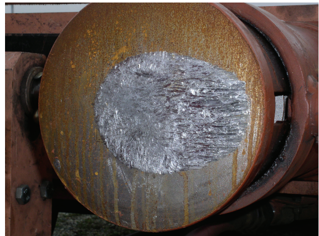
Rys. 8. Rysy i zadziory na powierzchni zderzaka diagonalnego [fot. A. Zbieć]
