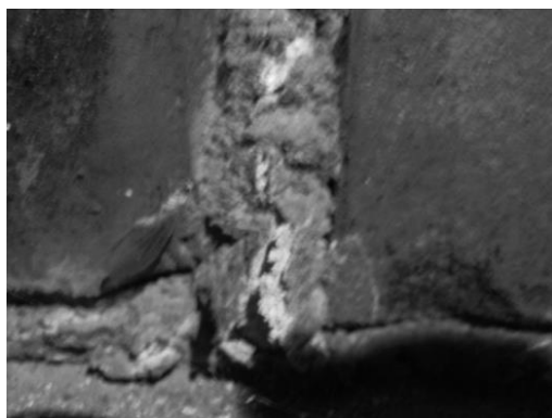
Rys. 3. Efekt subflorescencji zachodzącej w spoinie muru z elementów ceramicznych (fot. autor)
