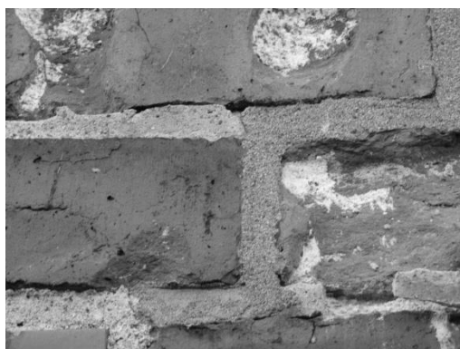
Rys. 2. Efekt subflorescencji w cegle licowej w postaci soczewek chlorku sodu (fot. autor)
