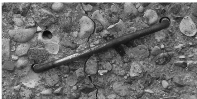
Rys. 3.2. Wzmocnienie pęknięcia warstwy fakturowej kotwą zszywającą
