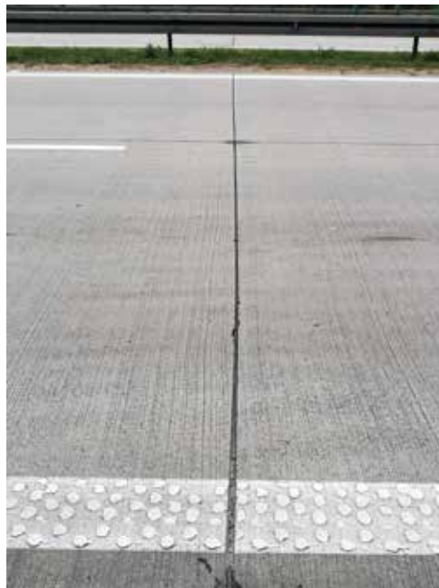
Fot. 1. Widok stanu szczeliny poprzecznej i szczeliny podłużnej – brak uszkodzeń. Źródło: [8]
