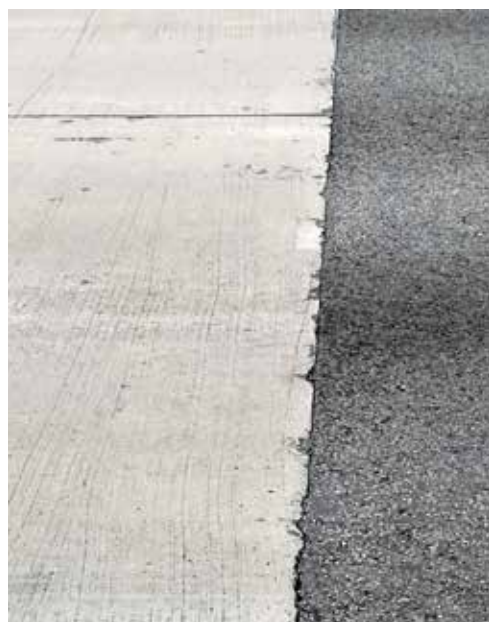
Fot. 4 (z lewej). Widok uszkodzeń na styku nawierzchni betonowej i asfaltowej w km 132+480. Źródło: [8]
