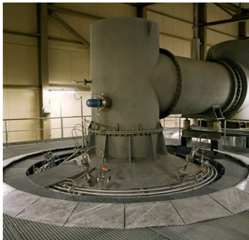
Kopuła pieca wraz z kanałem odlotowym spalin
