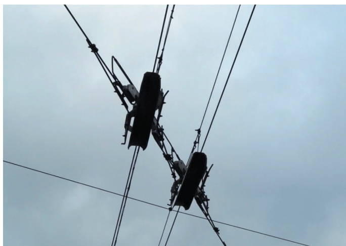
Rys. 3. Skrzyżowanie sieci trakcyjnej trolejbusowej i tramwajowej w Ostrawie w Republice Czeskiej Źródło: materiały własne
