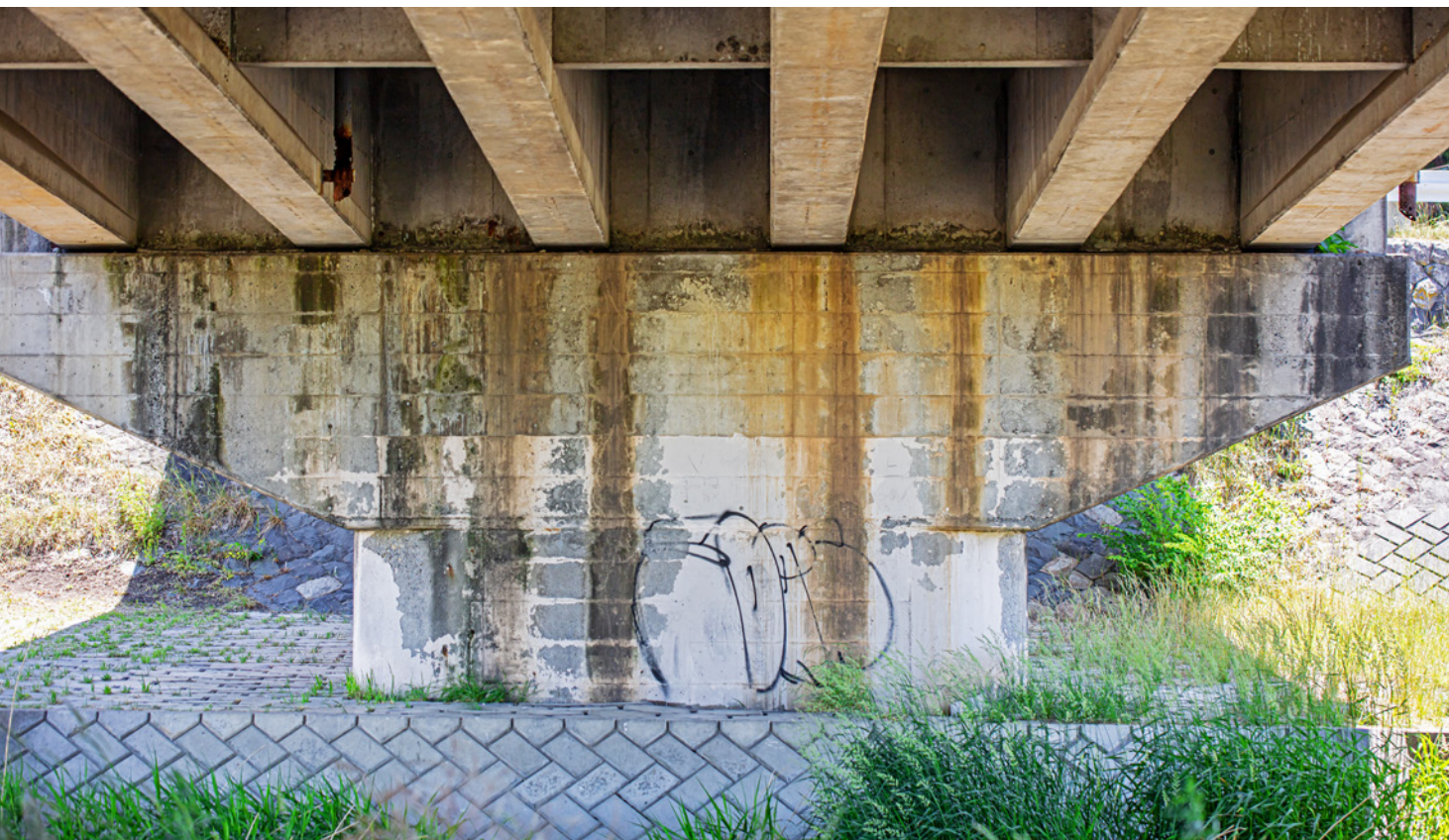
Istnieje wiele obiektów będących w trakcie eksploatacji, których stan wymaga lub w przyszłości będzie wymagał działań remontowych, fot. Adobe Stock
