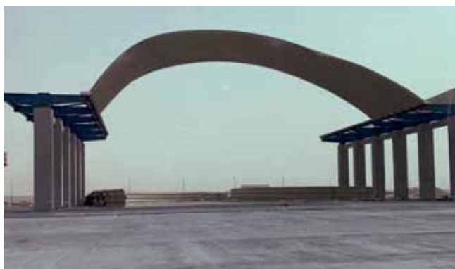
Rys. 2. Deformacja łukowego przekrycia ABM240 spowodowana oddziaływaniem wiatru
