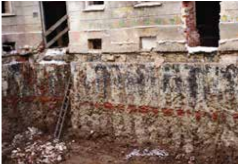
Widok na fragment ściany kamienicy i zabezpieczenie obiektu z wykorzystaniem kolumn jet grouting
