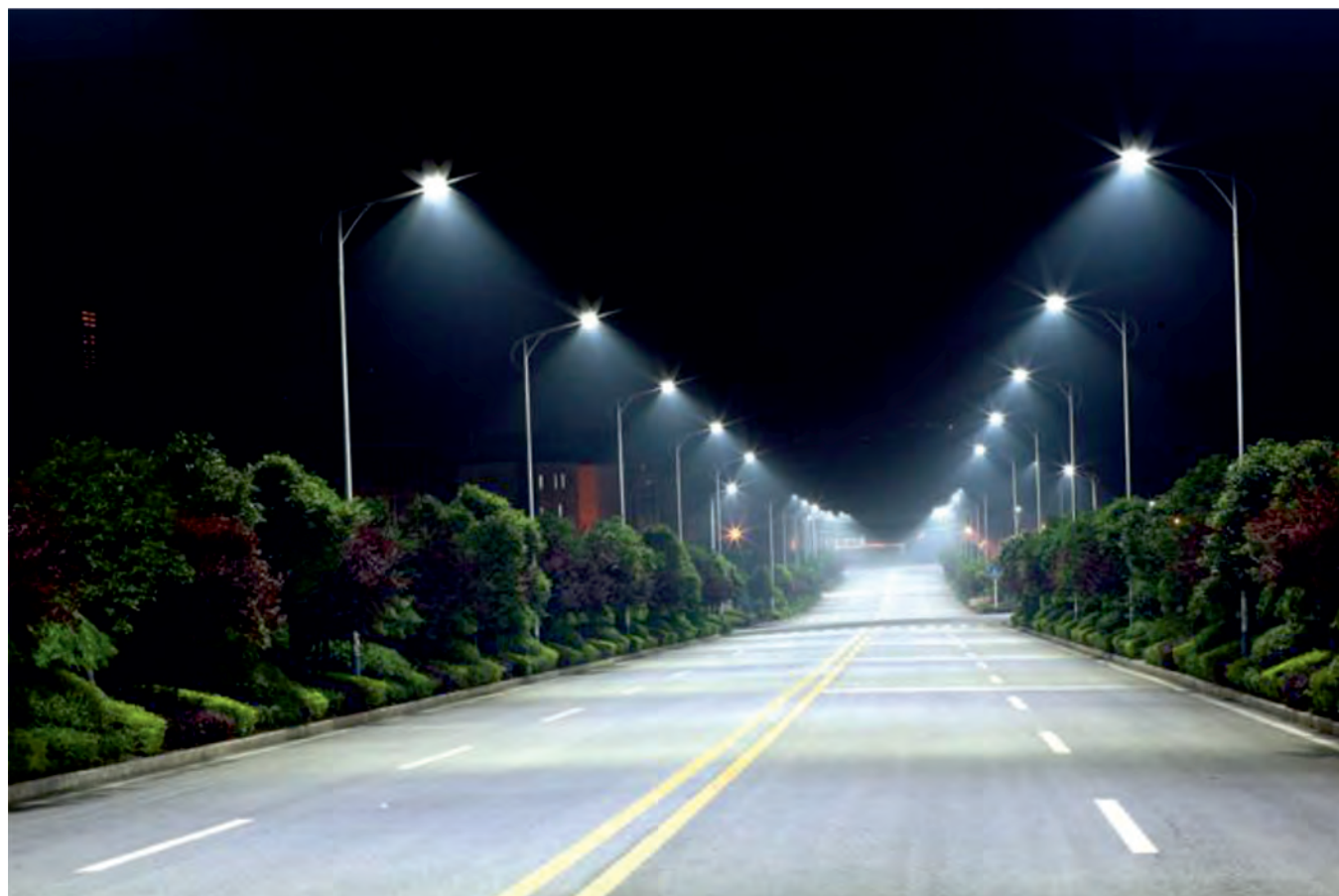
Fot. 4. Przykład oświetlenia ulicznego ( https://www.brasit.pl/oswietlenie-uliczne-led/lampy-uliczne/ ) Fig. 4. An example of street lighting ( https://www.brasit.pl/oswietlenie-uliczne-led/lampy-uliczne/ )
