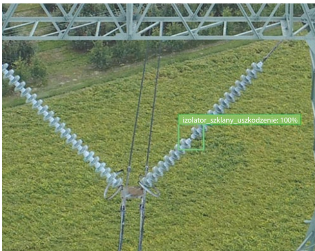
Rys. 10. Wykrycie usterki – uszkodzony izolator [11]
