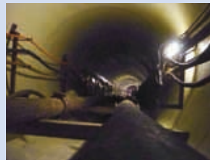
Ryc. 3. Widok wnętrza rury GRP o średnicy 2000 mm na zakrzywieniu o promieniu 400 m [1]
