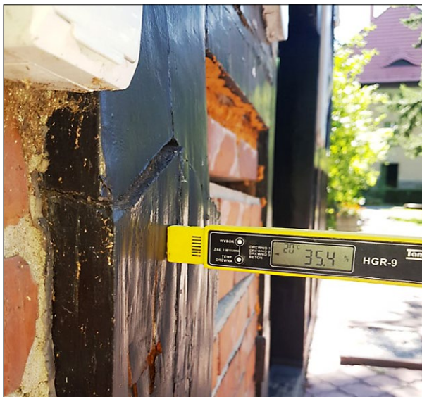
Ryc. 3. Pomiar zawilgocenia słupa drewnianego, odczyt 35,4 proc., 2019; fot. Stekra
