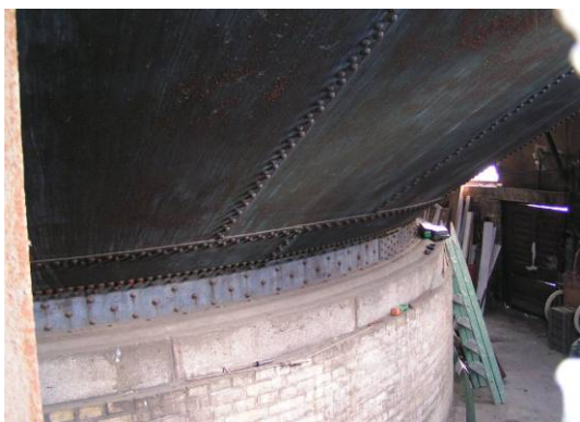
Fig. 4. Intze steel container in the interior of the degraded water tower 2012. Source: Arkadiusz Bis [3] Ryc. 4. Stalowy zbiornik typu Intze we wnętrzu zdegradowanej wieży ciśnień, 2012r. Źródło: Arkadiusz Bis [3]
